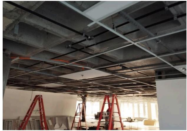
Foto 12: Torre 01 – 3º Pavimento – Instalações de infraestrutura de CFTV.
