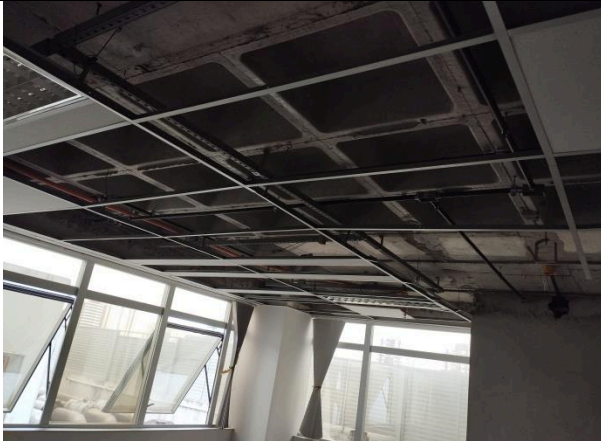
Foto 7: Torre 01 – 3º Pavimento - Infraestrutura de SDAI.
