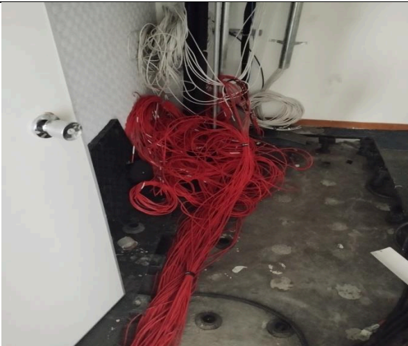
Foto 9: Torre 01 – 3º Pavimento - Cabeamento lançado na espera do Rack de telecomunicação.
