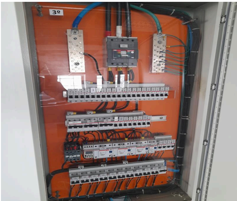
QUADRO DE DISTRIBUIÇÃO – 3º PAVIMENTO
