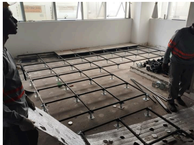
Foto 15: Torre 01 – 3º Pavimento – Instalação do piso da sala de contingência e data center.
