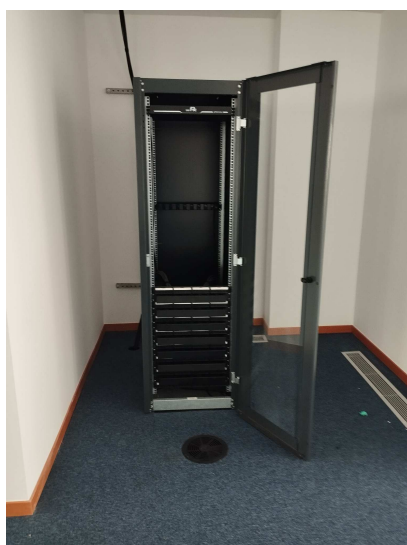
Foto 6 - Rack existente no 6º pavimento da Torre 2
