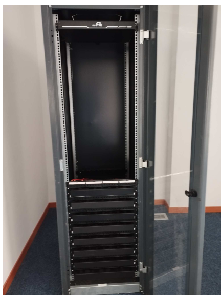
Foto 5 - Rack existente no 5º pavimento da Torre 2
