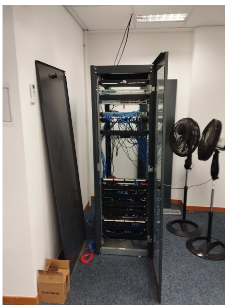
Foto 1 - Rack existente no 1º pavimento da Torre 2
