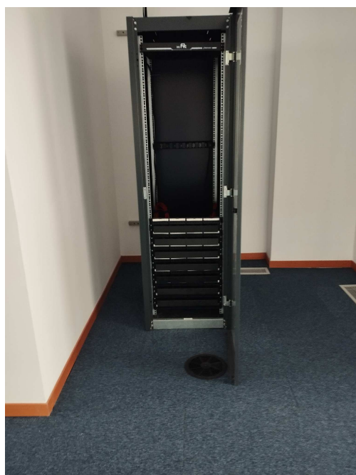
Foto 7 - Rack existente no 7º pavimento da Torre 2
