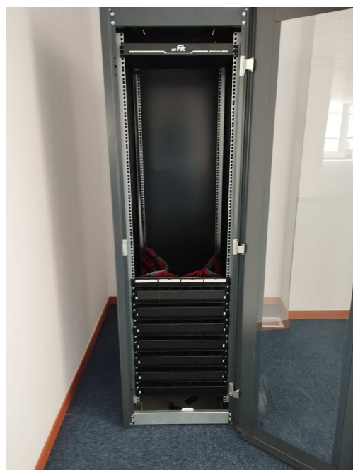
Foto 12 - Rack existente no 12º pavimento da Torre 2
