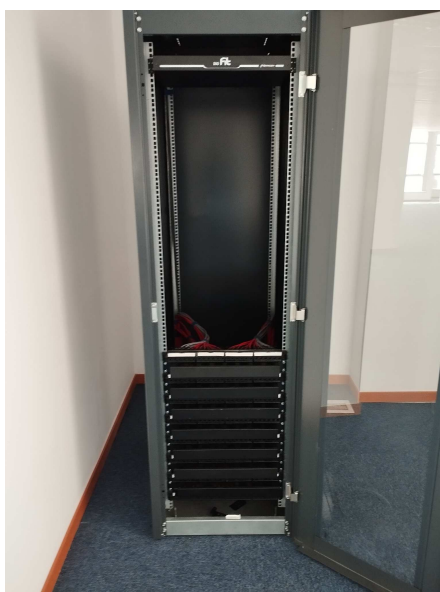
Foto 8 - Rack existente no 1º pavimento da Torre 2
