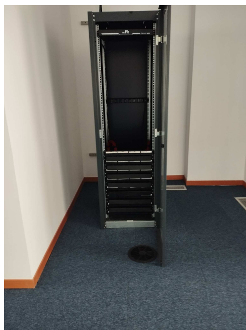
Foto 112 - Rack existente no 11º pavimento da Torre 2
