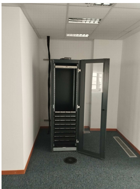
Foto 2 - Rack existente no 2º pavimento da Torre 2
