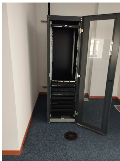
Foto 3 - Rack existente no 3º pavimento da Torre 2
