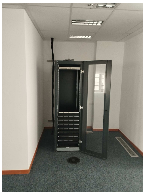
Foto 10 - Rack existente no 10º pavimento da Torre 2
