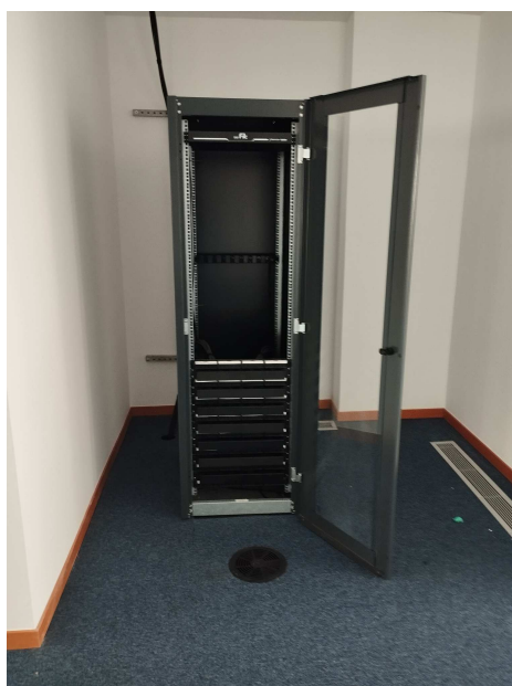
Foto 9 - Rack existente no 9º pavimento da Torre 2
