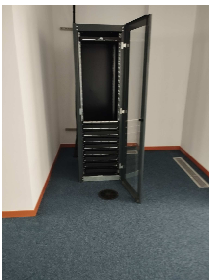
Foto 4 - Rack existente no 4º pavimento da Torre 2
