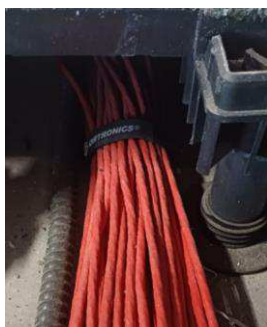
Figura 1: Cabeamento Estruturado no Piso Elevado
