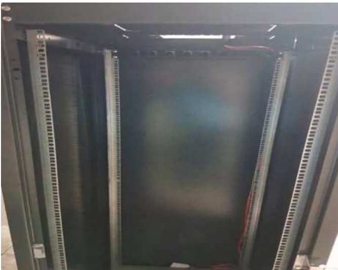
Foto 5: Torre 01 – 1º Pavimento – Vista Interna do Rack 44U.
