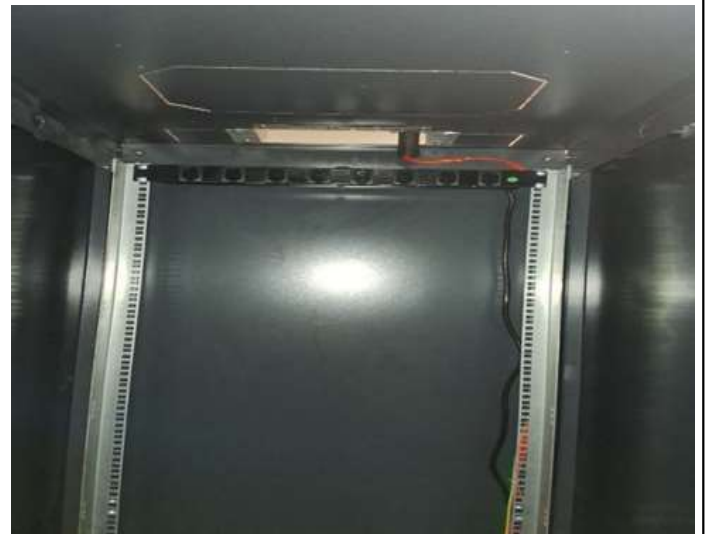
Foto 6: Torre 01 – 1º Pavimento – Alimentação Elétrica
