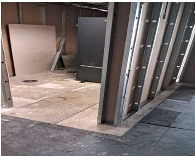
Foto 1: Torre 01 – 1º Pavimento – Sala de Telecomunicações
