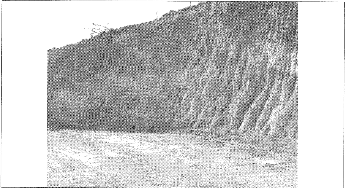
Figura 01. Corte executado pela Construtora NM fora das determinações técnico-normativas (NBR 9061). Foto de 04 de março de 2010.
