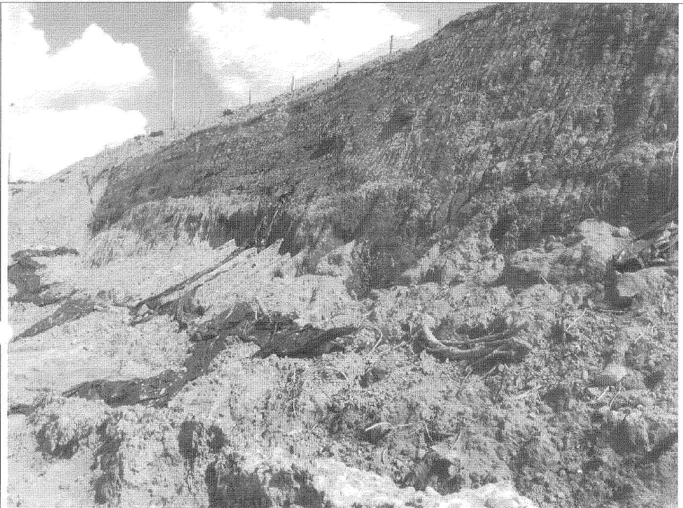
Foto 3. Estado de instauração de processos erosivos nos taludes expostos.
