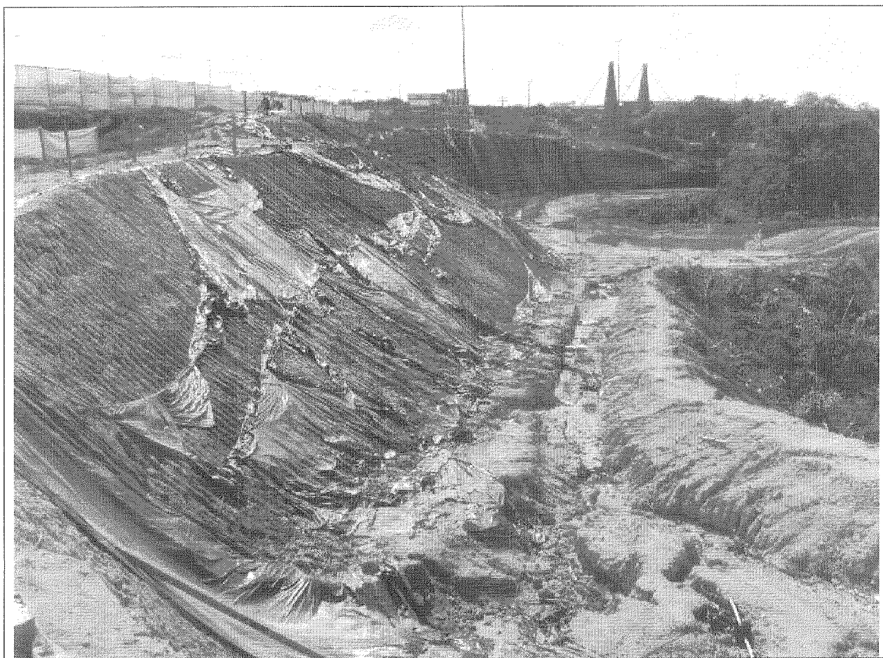
Foto 1. Atual situação da obra de Terraplenagem e contenção, sugerindo abandono, bem como evidenciando o grau de vulnerabilidade do talude exposto às intempéries.
