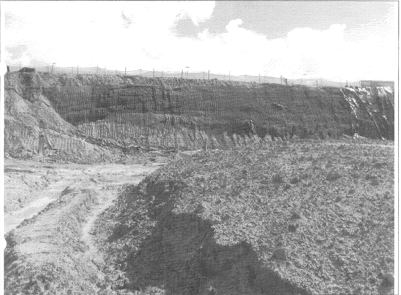
Foto 2. Exposição do talude (praticamente vertical) realizado em não-conformidade com a norma, e totalmente exposto às intempéries. Ilustrando, inclusive, iniciação de processos erosivos.
